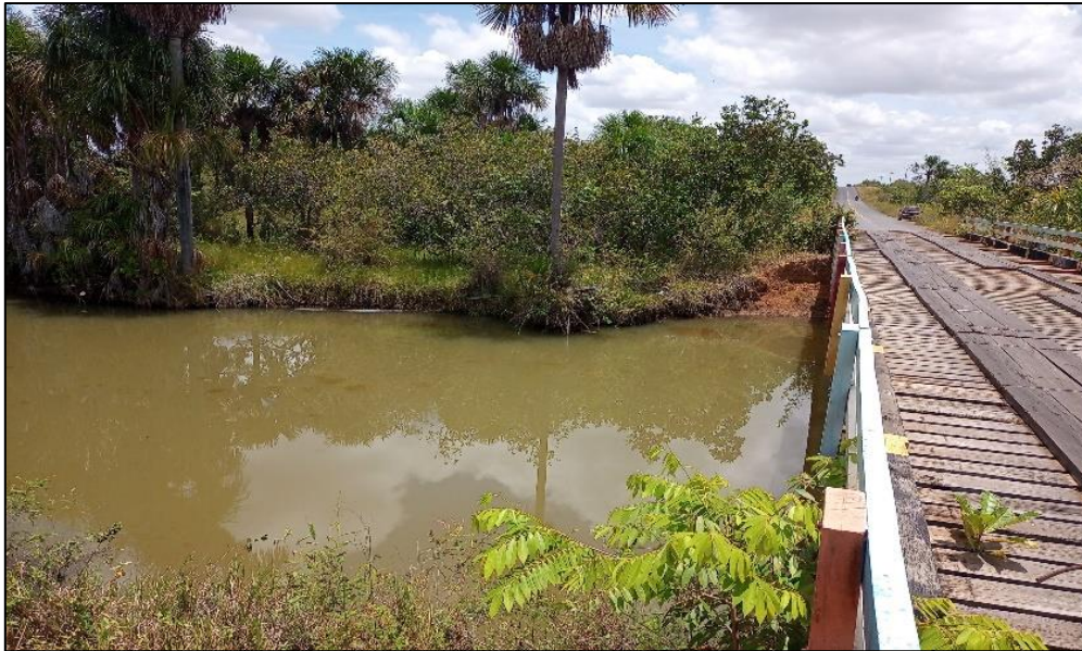
Figura 6: Ponte sobre o igarapé Arurai, fonte principal de contaminação por óleo de veículos que trafegam na BR-203.
