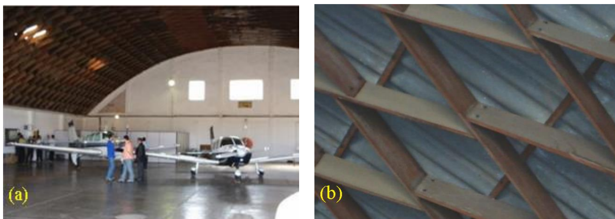
Figura 1: Hangar do Aeroclube de Poços de Caldas (a) e detalhe da cobertura de madeira lamelar semicilíndrica. Fonte: Brito e Calil Jr. (2017).
