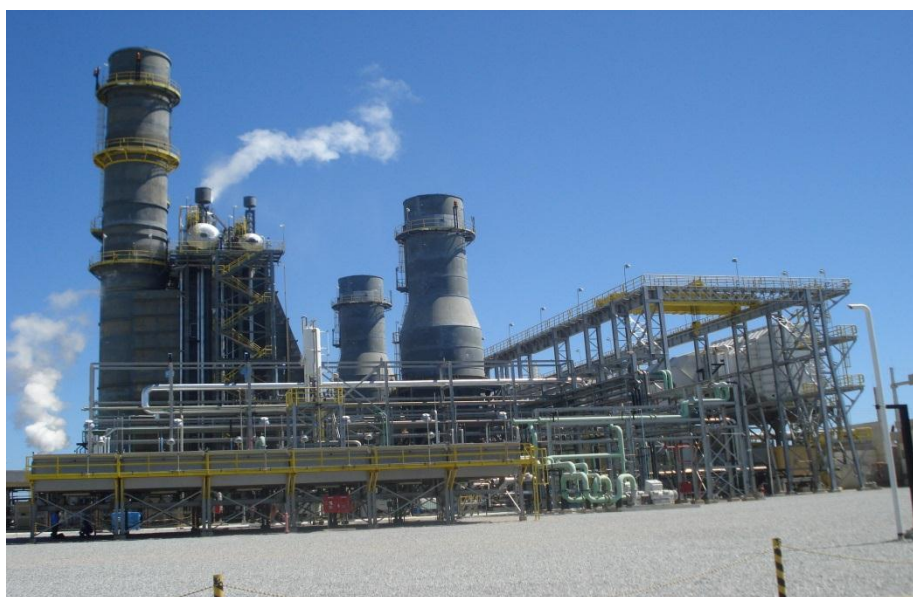
Figura 3: Caldeiras e chaminés da Termoaçú, Alto do Rodrigues (RN). Fonte: Gurgel, Queiroz, Santos, Galvão (2011)
