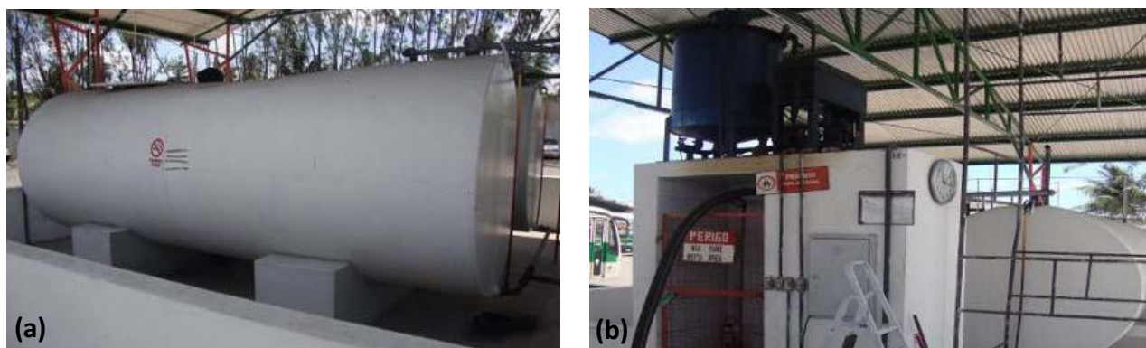
Figura 3 – Infraestrutura: (a) tanque reservatório e (b) bomba de abastecimento
