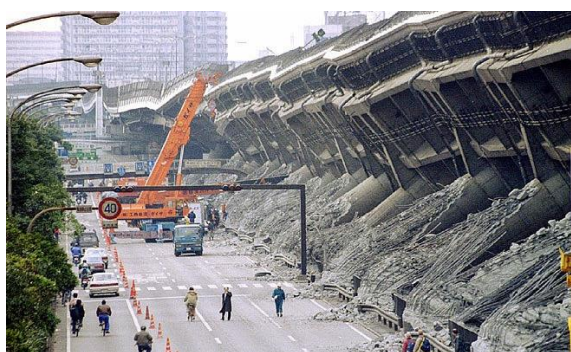
Viaduto, Kobe / Japão, 1995
