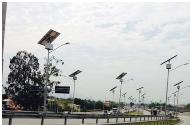
Figura 3. Sistema de iluminação noturno da Rodovia Arco Metropolitano, consistindo de painel solar, bateria chumbo ácido e lâmpada de LED. A energia é produzida durante o dia e é armazenada na bateria para prover iluminação durante a noite.
