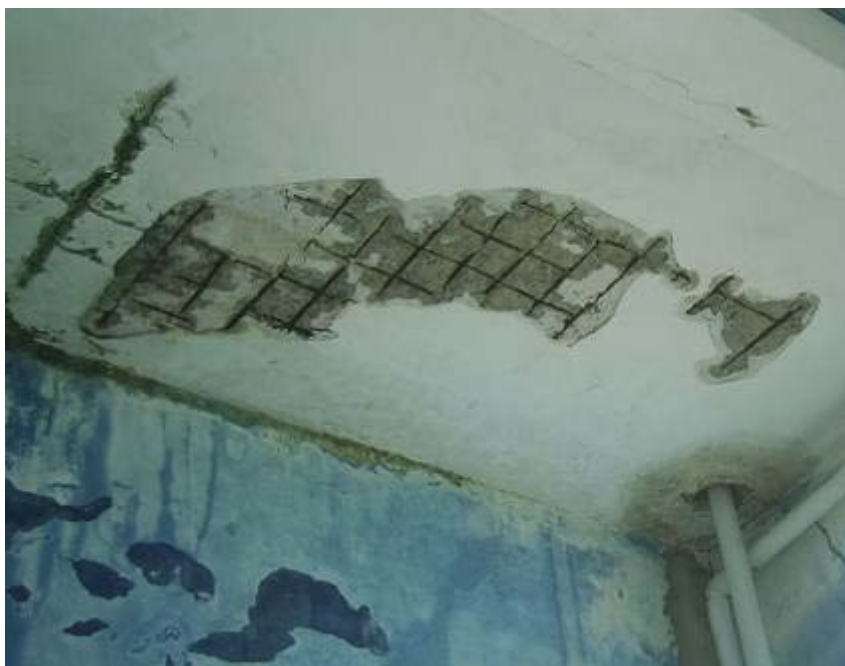
Figura 14 - Detalhe de laje de concreto armado deteriorada por corrosão.
