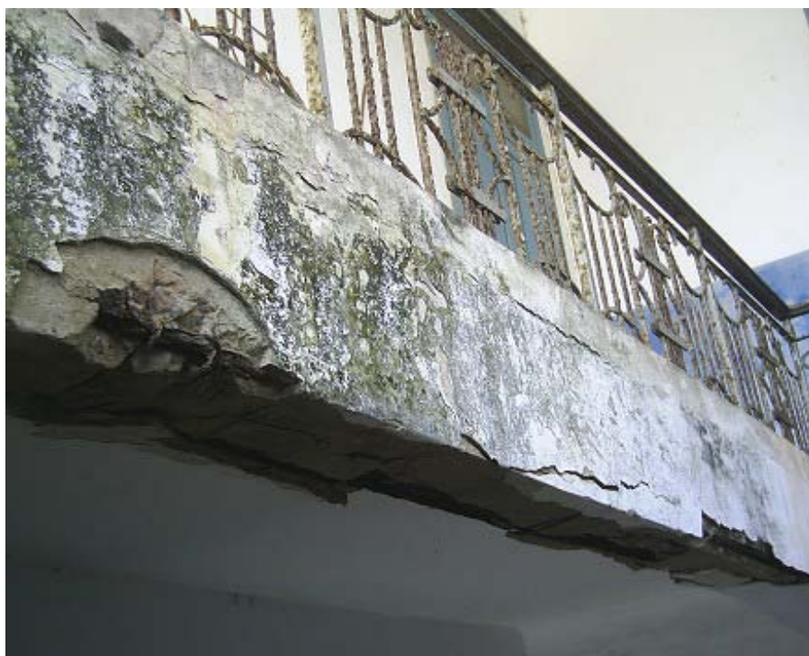
Figura 15 - Severa redução da seção transversal da armadura de viga da escada.
