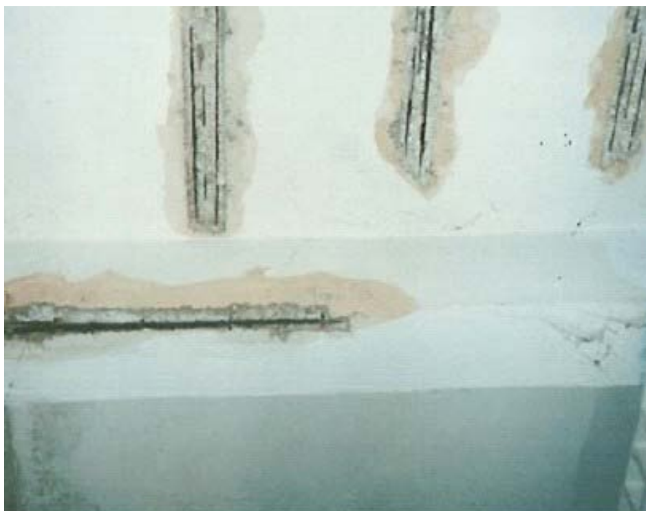
Figura 2 - Viga e laje atacada por corrosão das armaduras.
