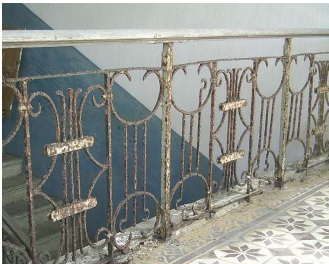
Figura 16 - Detalhe do estado de deterioração de gradis metálicos.
