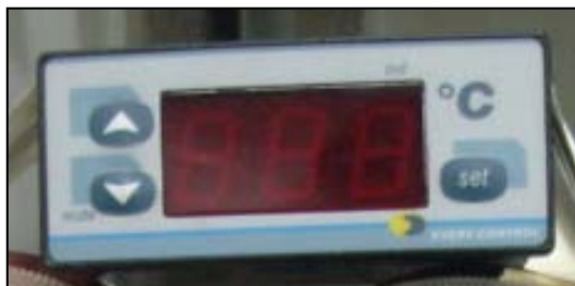
Figura 04: Controlador digital de temperatura
