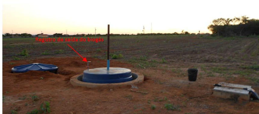
Figura 7 – Destaque do registro de saída do biogás no biodigestor construído Fonte: elaborado pelos autores
