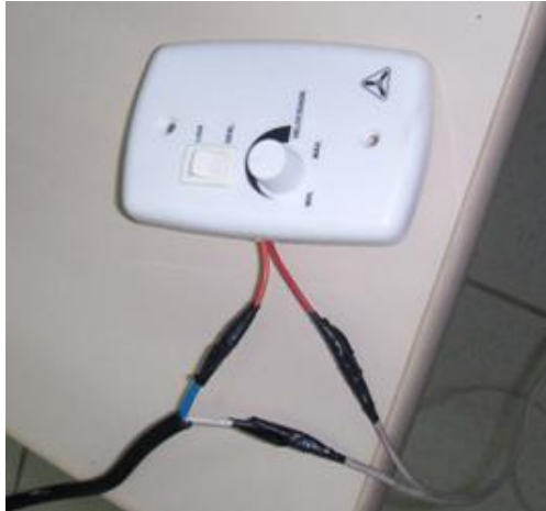
Figura 2 – Dimmer para controlar a velocidade do ventilador.
