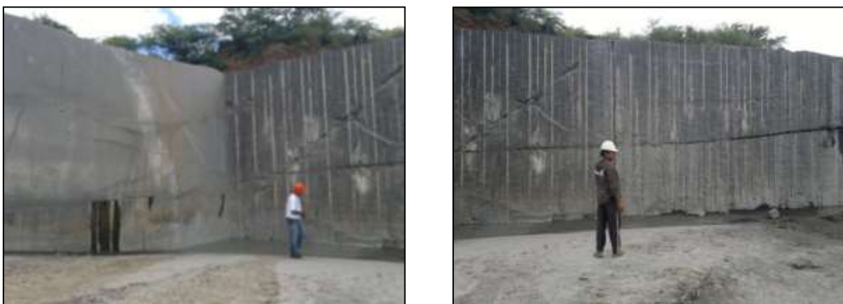
Figura 1 - Vista frontal do maciço rochoso, mostra fratura sub-horizontal que corta o maciço da esquerda para direita.
