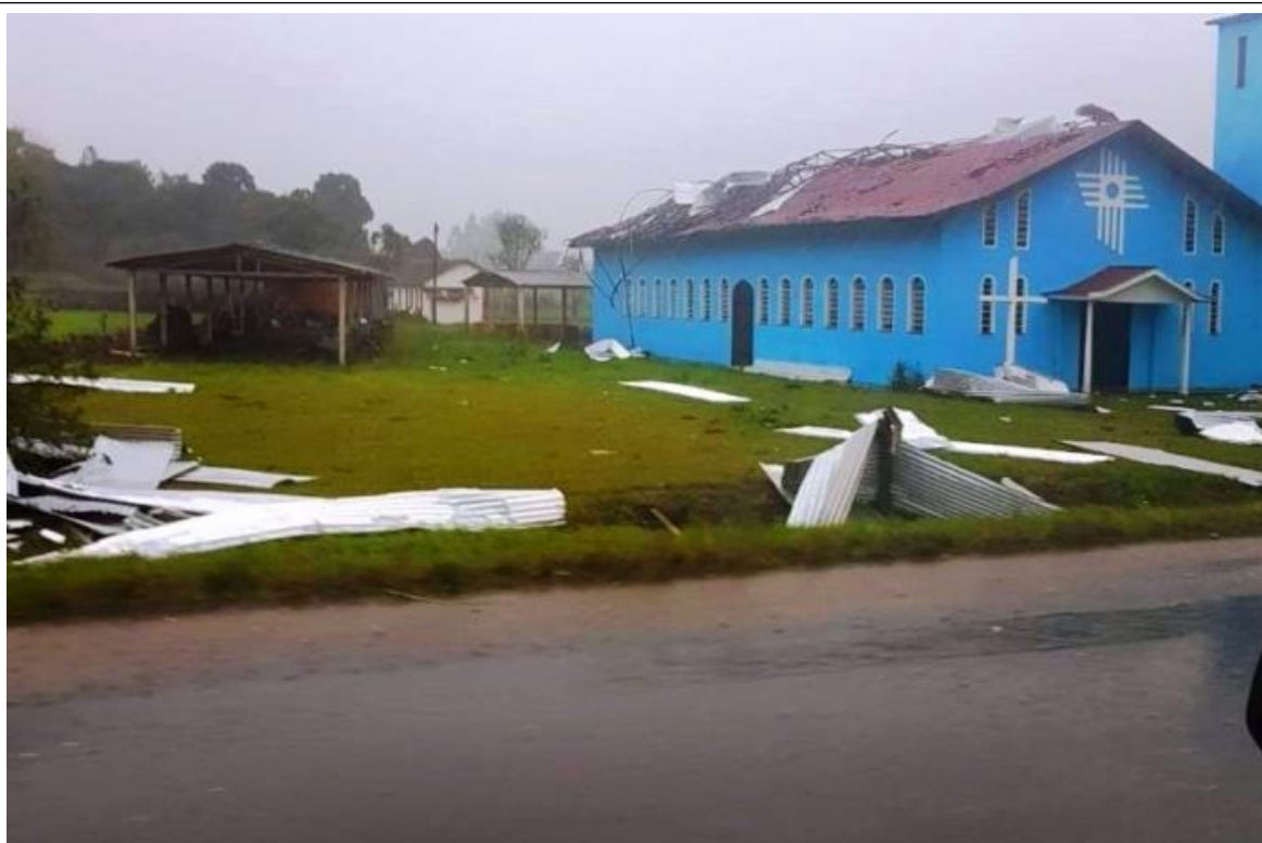
Figura: 51 - Igreja sendo destelhada por ventania
