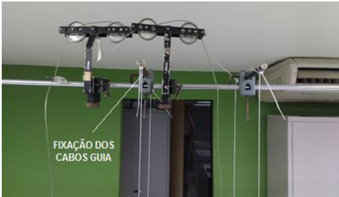
Figura 4 Roldanas, cabo de sustentação do elevador e cabos-guia.
