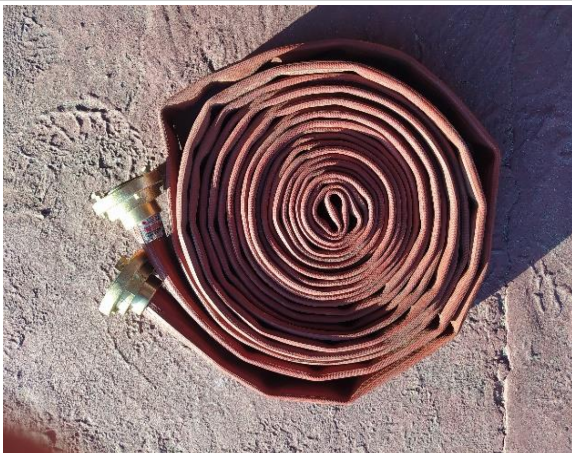
Figura: 99 - Mangueira de incêndio tipo 4 de 1 ½"
