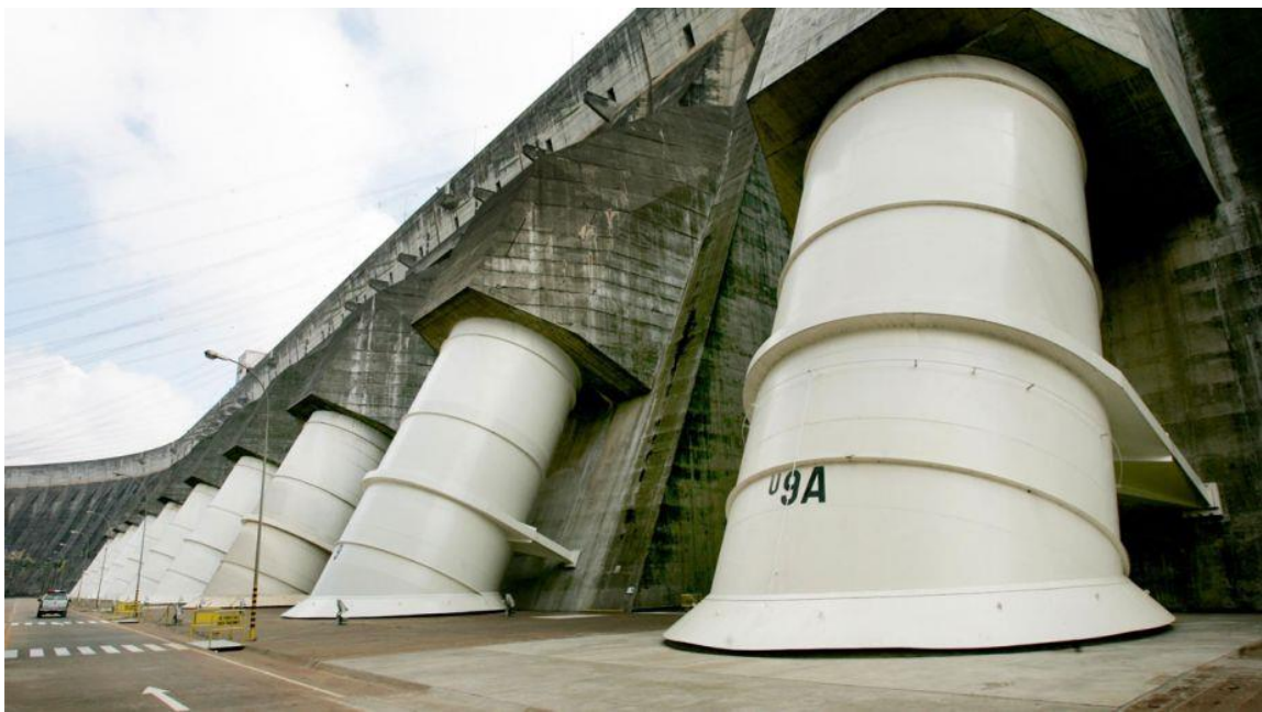
Figura: 39 - Dutos de Itaipu
