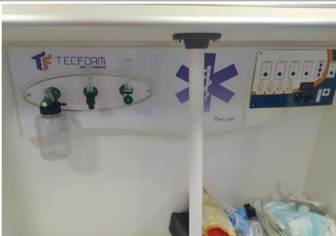
Figura: 80 - Régua de gases com quadro de tomadas e luzes indicadoras.
