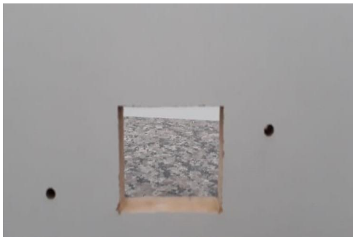
Figura 4: Corte na estrutura de madeira para acoplar o disjuntor. Fonte: Arquivo pessoal do autor
