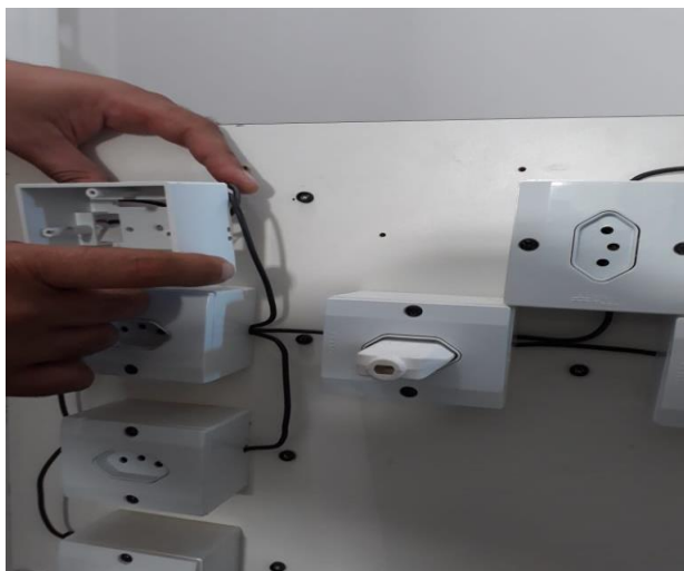
Figura 11: Desmontando o painel elétrico para a visualização dos componentes constituintes. Fonte: Arquivo pessoal do autor
