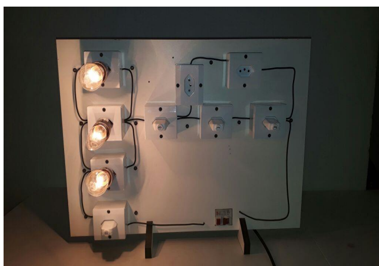
Figura 10: Painel elétrico com montagem para circuito em paralelo com três lâmpadas Fonte: Arquivo pessoal do autor.
