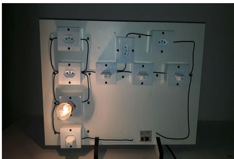
Figura 8: Painel elétrico com montagem para circuito em paralelo com uma lâmpada Fonte: Arquivo pessoal do autor.
