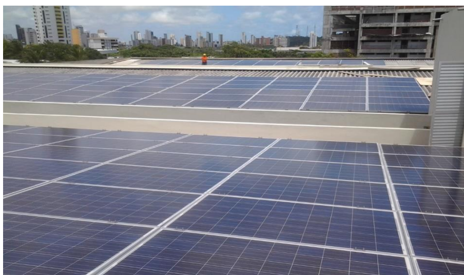
Figura A2: UFV REITORIA IFRN: 240 painéis de 235 Wp = 56,4 kWp.
