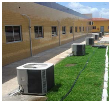
Figura 4: Condensadores de ar do bloco B do IFRN Câmpus zona Norte.
