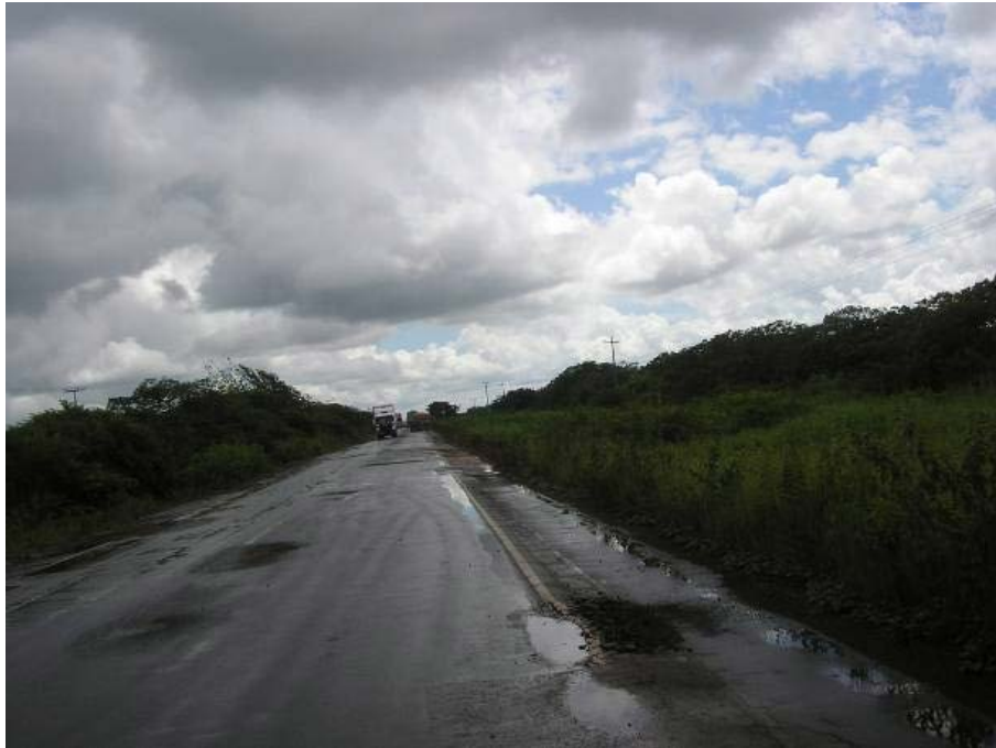
Figura 1 - Condições precárias do pavimento em quase toda a rodovia- BR 304 CE.
