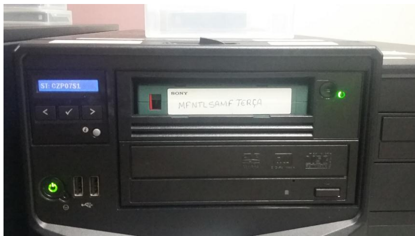
Figura 36: Fita de backup no servidor da SAMF
